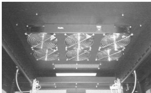
Установленный вентиляторный блок TLK-FAN6-BK
