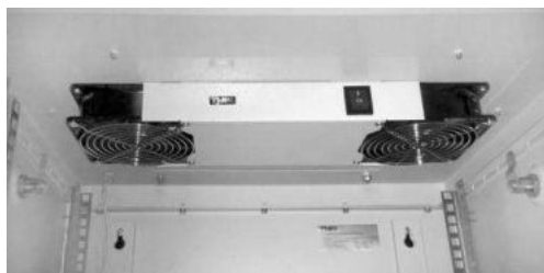
Установленный вентиляторный блок в шкафу
