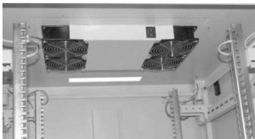
Установленный вентиляторный блок в шкафу
